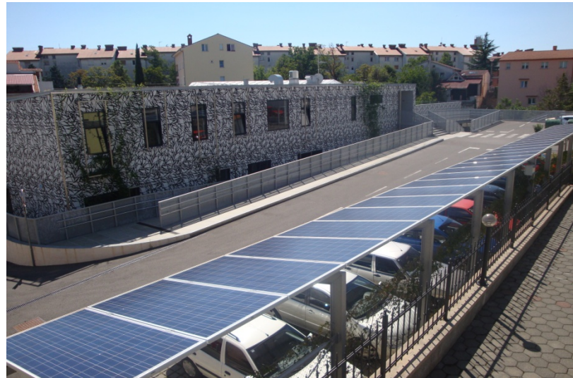
FNE na nadstrešnici parkirališta DV Srdoči, Rijeka
