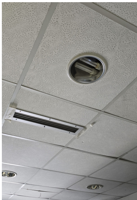
Слика 67: Изглед вентилационе решетке
