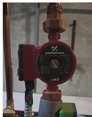
Слика 78: Изглед циркулационе пумпе
