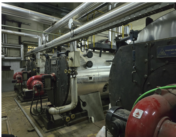
Слика 23: Приказ котлова на мазут
