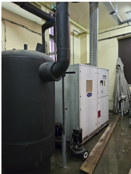
Слика 30: Приказ расхладне машине са акумулатором хладне воде
