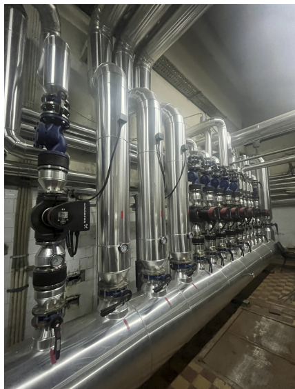
Слика 25: Приказ изолованих цеви у топлотној подстанци
