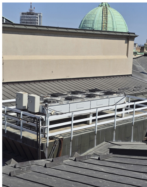
Слика 31: Приказ ваздухом хлађеног кондензатора на крову објекта
