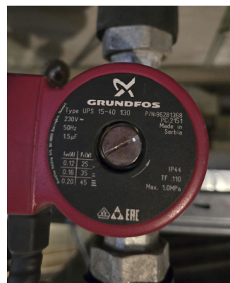
Слика 84: Изглед циркулационе пумпе
