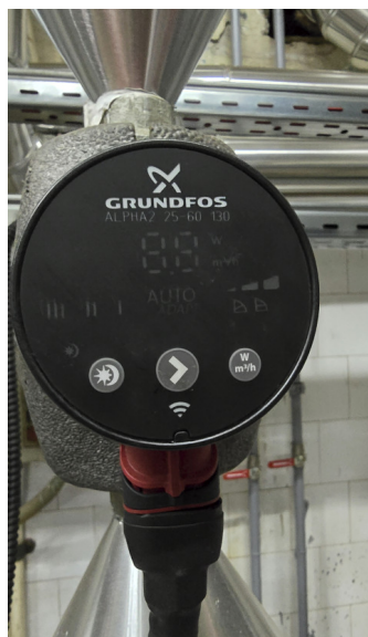
Слика 97: Приказ циркулационе пумпе тип: "Grundfos" Alpha 2 25-60-130
