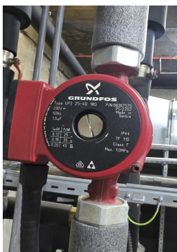
Слика 88: Изглед циркулационе пумпе
