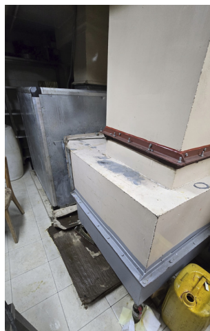
Слика 73: Изглед вентилатора за извлачење масних пара
