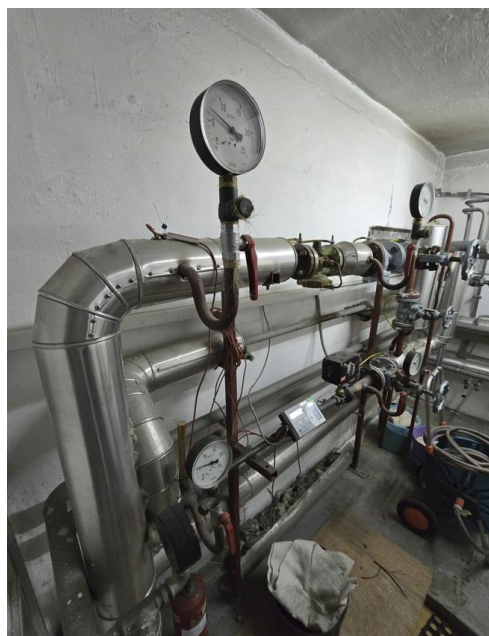
Слика 23: Приказ изолованих цеви у топлотној подстаници
