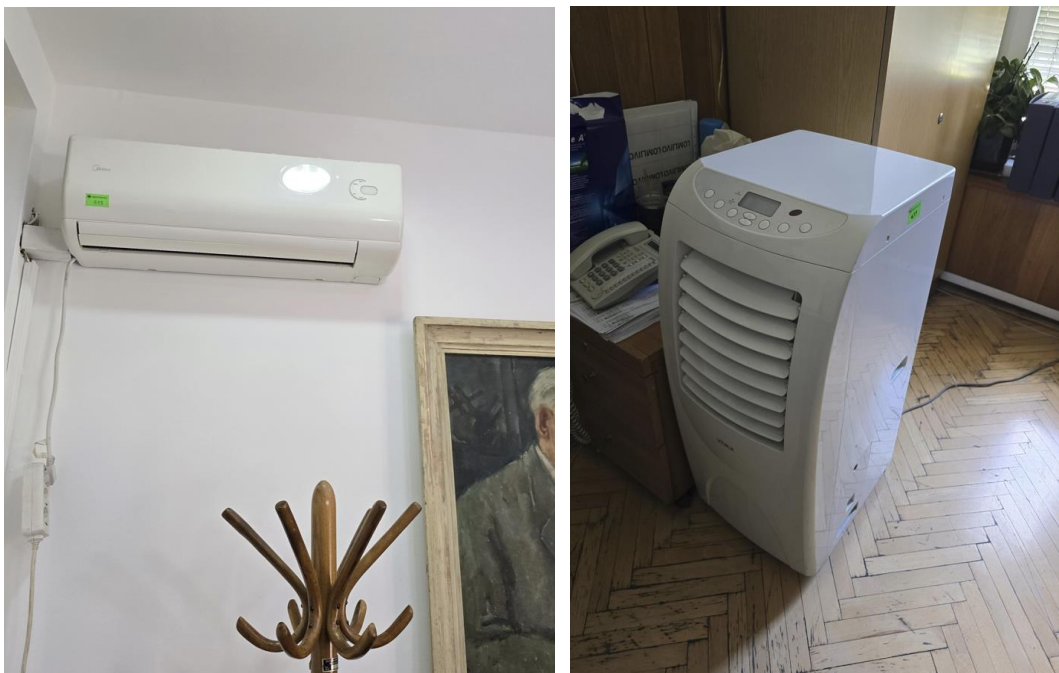
Слика 29: Унутрашње јединице уређаја за хлађење просторија зграде на адреси Ташмајдански парк б.б. (сплит систем)
