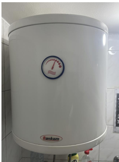
Слика 30: Изглед бојлера за припрему санитарне топле воде у бифеу
