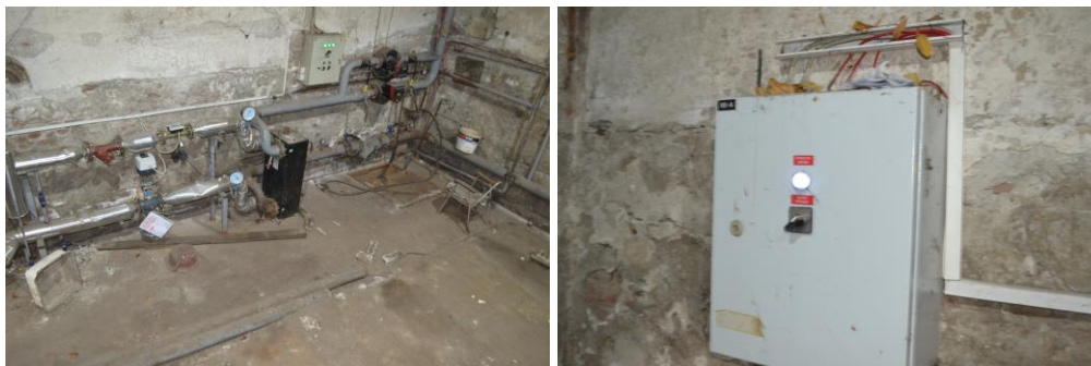
Слика 27 Топлотна подстананица индиректног типа са даљинским читавањем утрошене топлотне енергије
