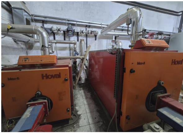
Слика 18: Приказ гасних котлова
