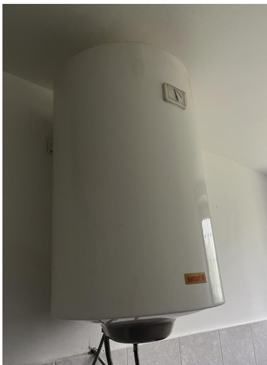
Слика 24: Изглед бојлера за припрему санитарне топле воде у објекту
