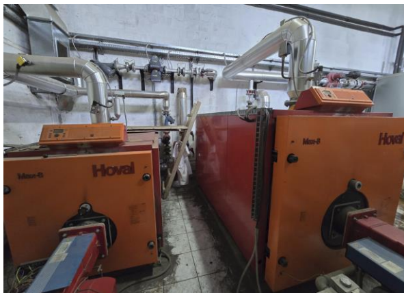
Слика 18: Приказ гасних котлова
