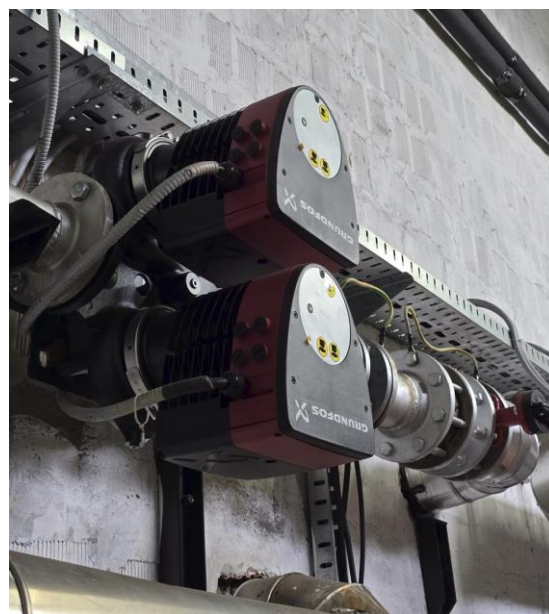
Слика 21: Приказ радне и резервне фреквентно регулисане циркулационе пумпе произвођача Grundfos
