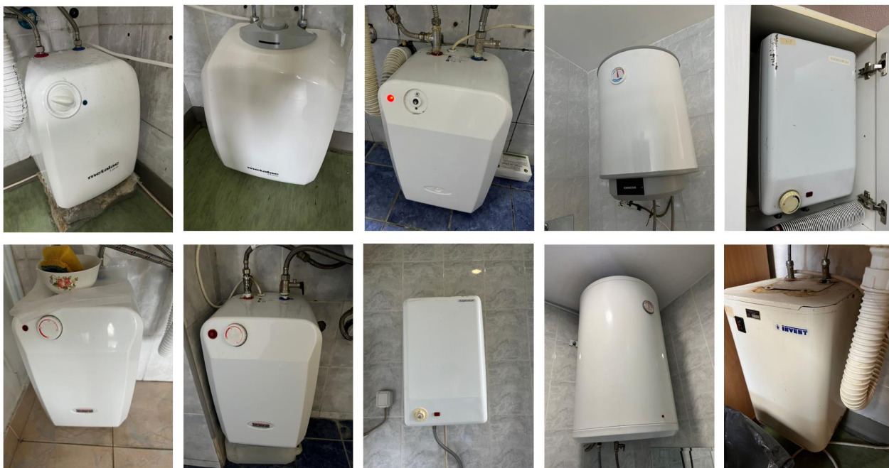
Слика 24: Изглед бојлера за припрему санитарне топле воде у објекту
