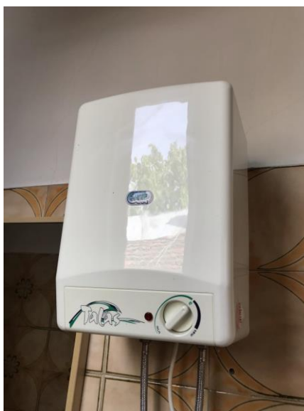
Слика 19: Изглед бојлера за припрему санитарне топле воде у тоалету
