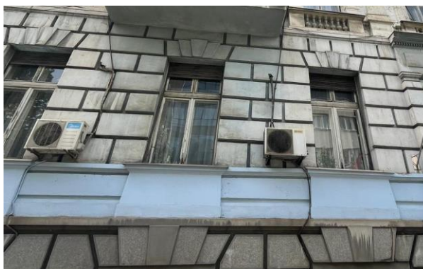
Слика 18: Изглед спољашње јединице сплит уређаја на фасадном зиду
