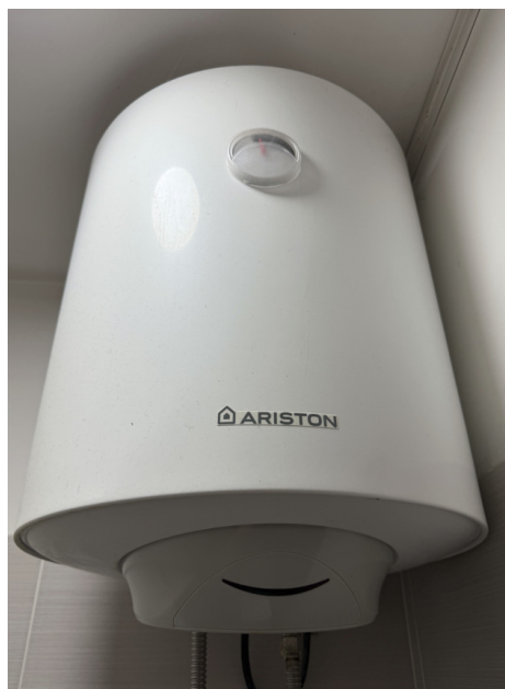
Слика 18: Изглед бојлера за припрему санитарне топле воде
