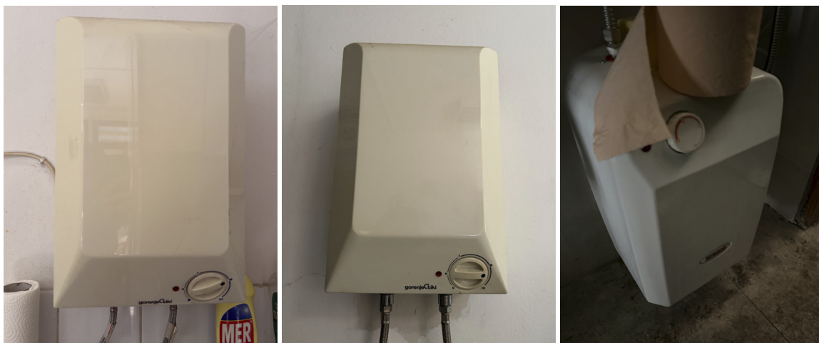
Слика 22: Изглед бојлера за припрему санитарне топле воде
