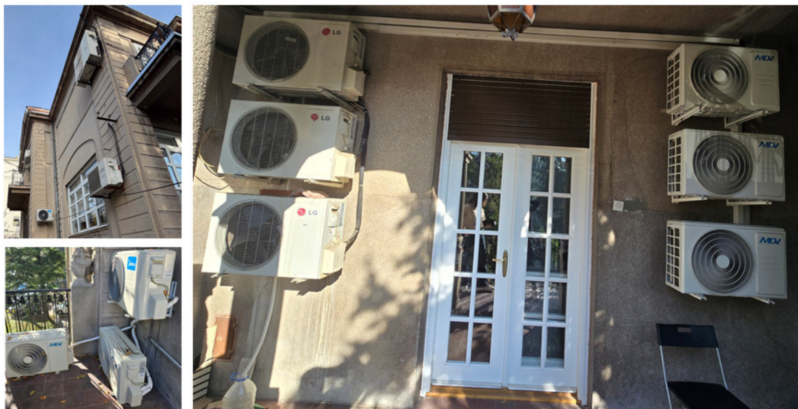
Слика 28: Изглед спољашњих јединица сплит уређаја
