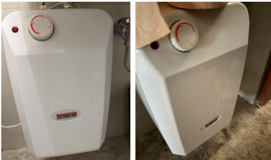
Слика 29: Изглед бојлера за припрему санитарне топле воде
