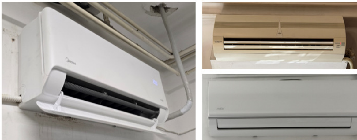
Слика 27: Изглед унутрашњих јединица сплит уређаја
