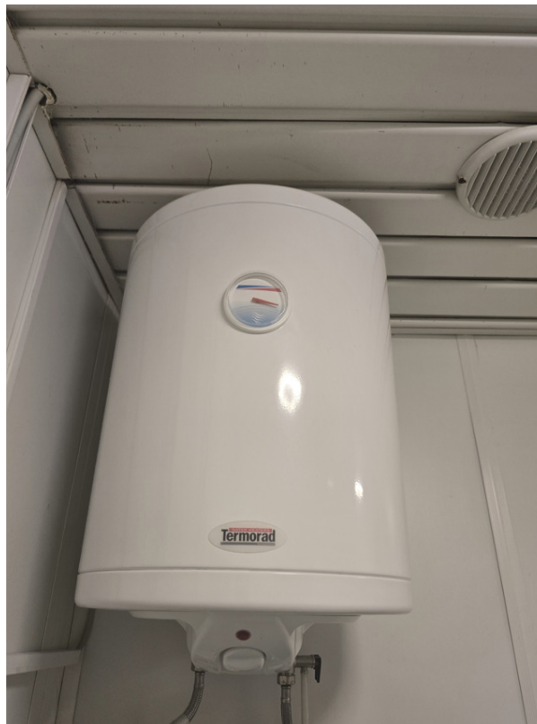
Слика 34: Изглед бојлера за припрему санитарне топле воде
