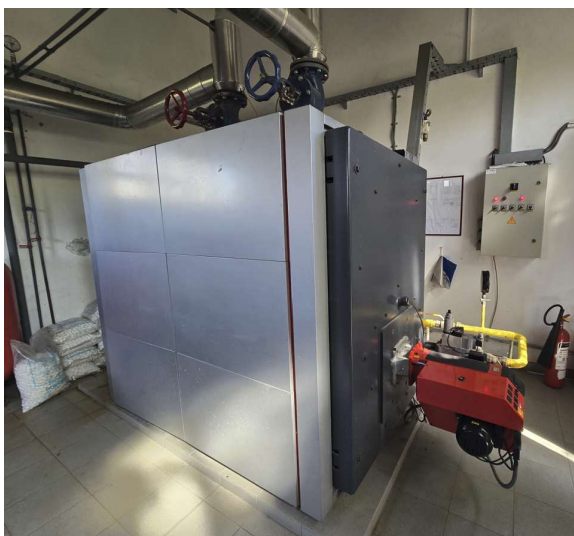
Слика 21: Приказ гасног котла
