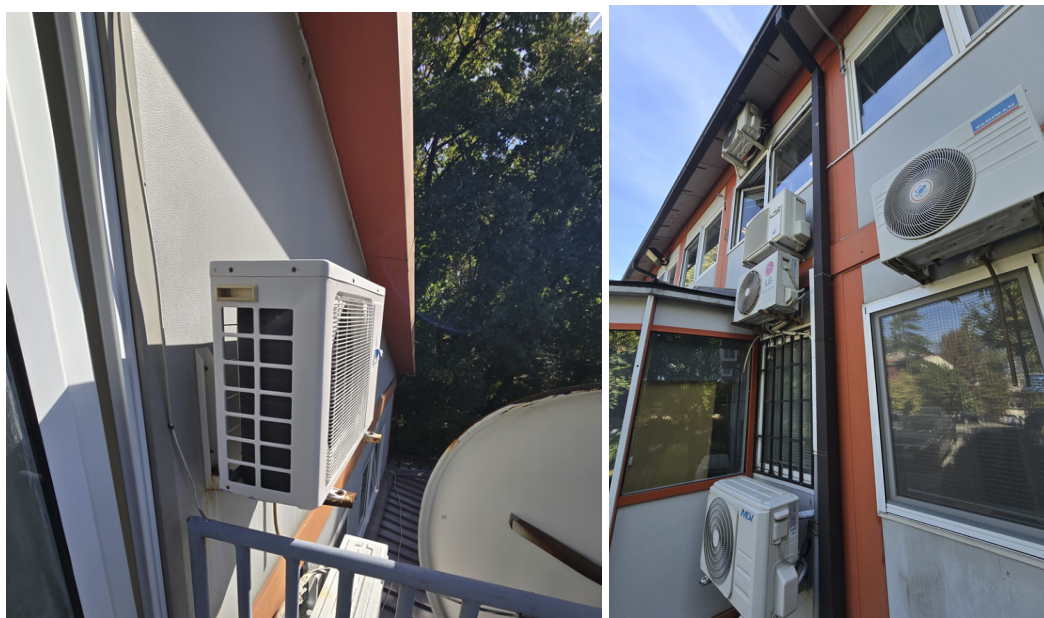
Слика 33: Изглед спољашњих јединица сплит уређаја
