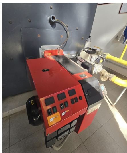
Слика 22: Приказ горионика гасног котла
