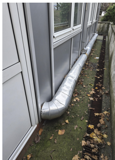
Слика 28: Приказ топлотизоловане цевне мреже на улазу у машинску салу
