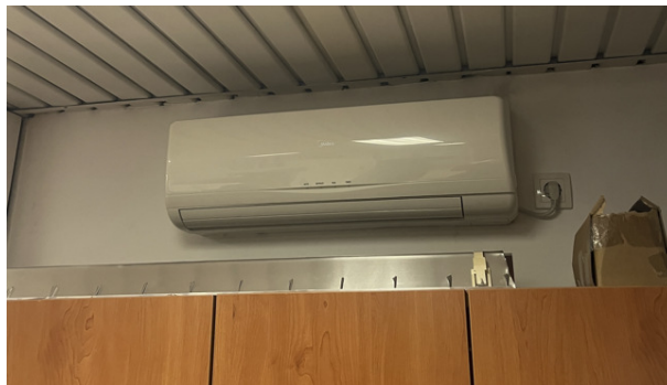
Слика 32: Изглед унутрашњих јединица сплит уређаја
