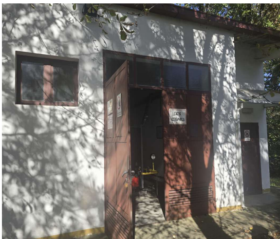
Слика 25: Приказ гасне котларнице
