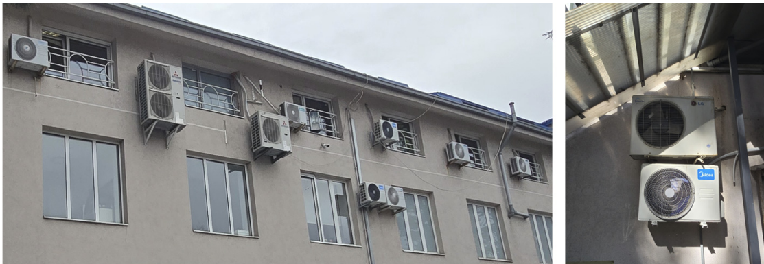
Слика 30: Спољне јединице уређаја за хлађење просторија зграде у улици Булевар војводе Степе 458 (сплит систем)
