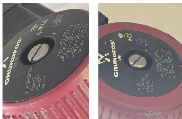
Слика 28: Приказ циркулационих пумпи произвођача Grundfos у гасној котларници
