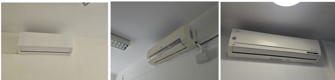
Слика 31: Унутрашње јединице уређаја за хлађење просторија зграде у улици Булевар војводе Степе 458 (сплит систем)
