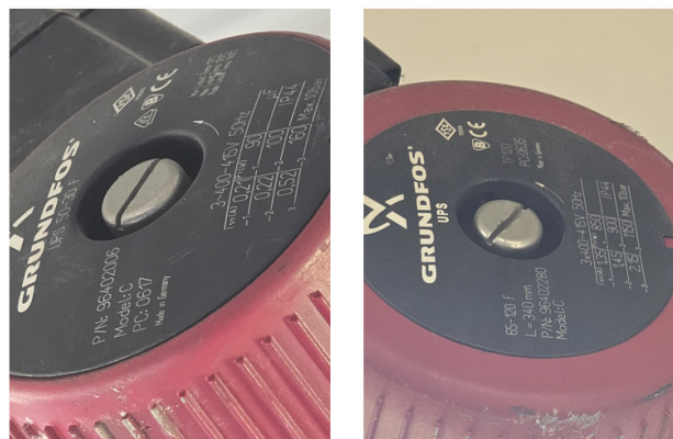
Слика 28: Приказ циркулационих пумпи произвођача Grundfos у гасној котларници
