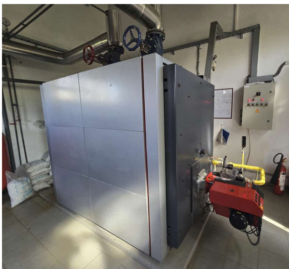
Слика 23: Приказ гасног котла
