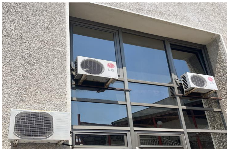
Слика 20: Изглед спољашње јединице сплит уређаја на фасадном зиду
