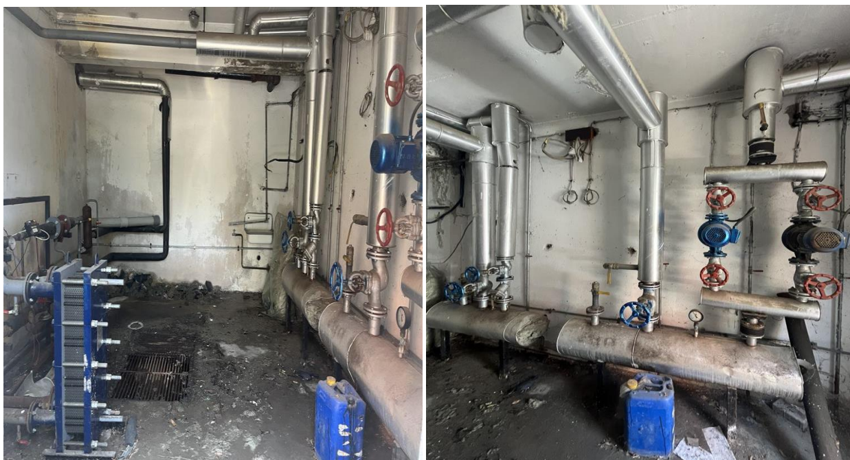
Слика 18: Изглед топлотне подстанице у сутерену
